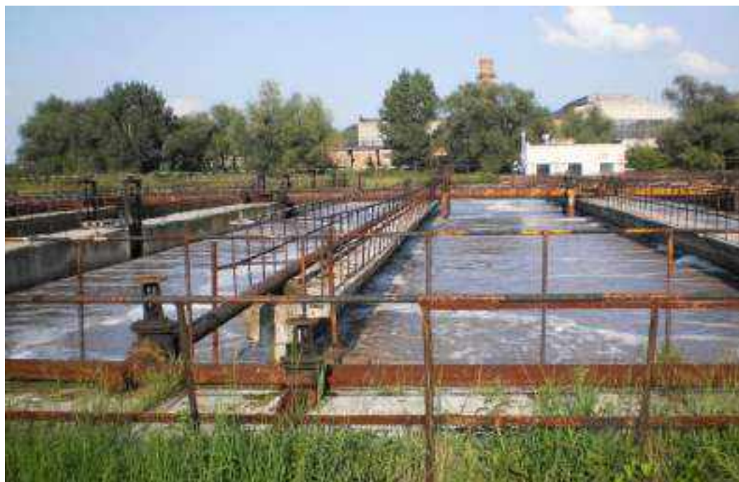
Рис 2.19. Аеротенки на очисних спорудах м. Львова (фото автора)
